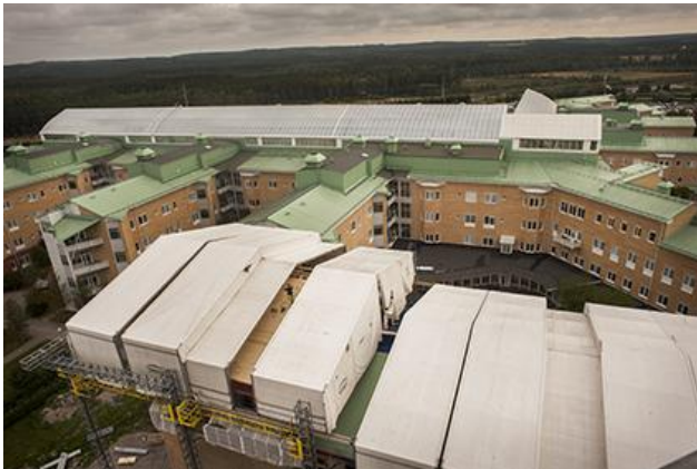
Bild 5. Vid uppförandet av det nya patienthotellet täcktes bygget av ett "mobilt supertält" som skyddar betongen från fukt och möjliggör en tidigare start av installationsarbetena.
